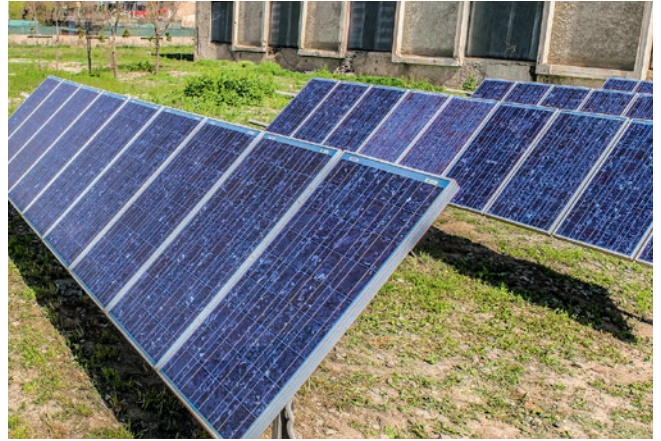
Anlagen für erneuerbare Energien wurden an den afghanischen Stromversorger übergeben | © GIZ
